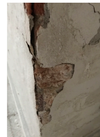
Fugtskader på murværk i kælderen
