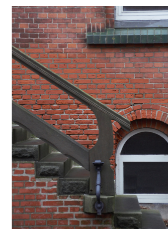
Fugeskader og spængte mursten
