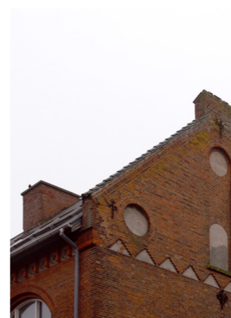
Fugeskader ved brandmur
