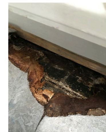
Oprindeligt trægulv under linoleumsgulv på tagetagen
