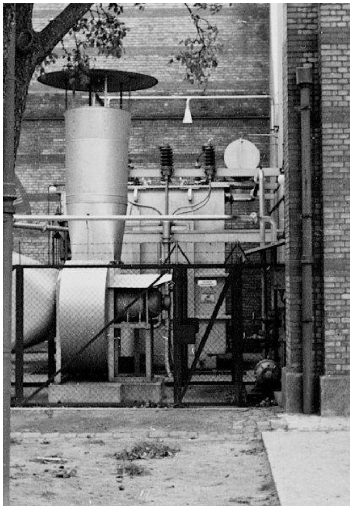
Østre Elektricitetsværk Maskineri i gården 1944
